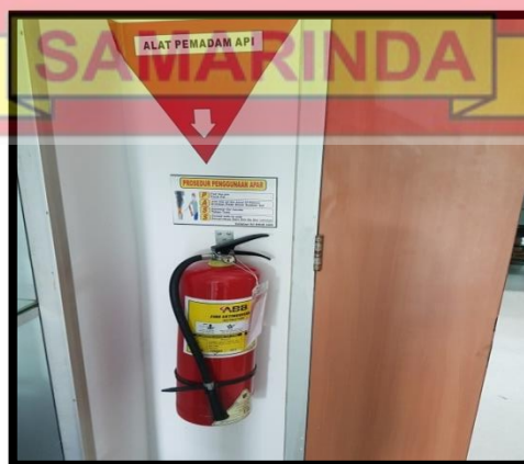
Gambar 28. APAR (Alat Pemadam Kebakaran)
