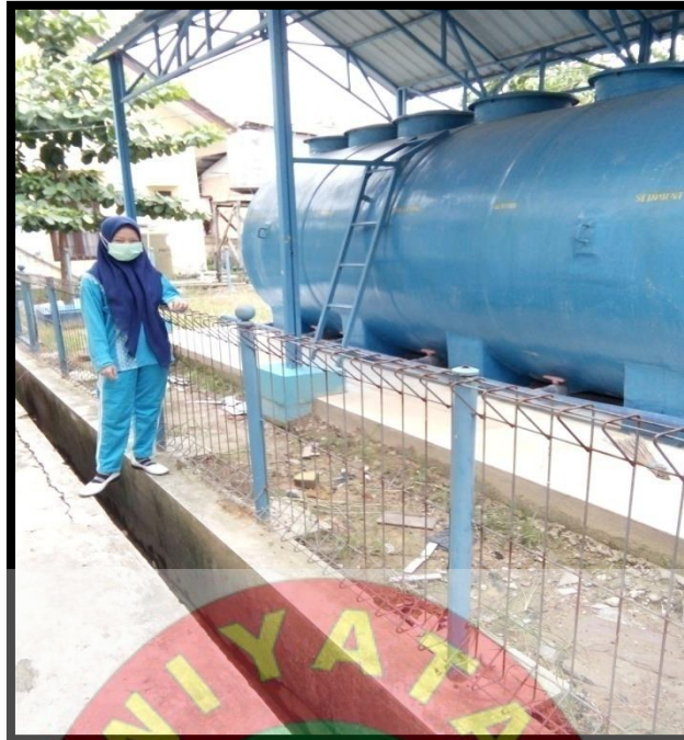
Gambar 3 IPAL Yang Ada Di Puskesmas Lempake
