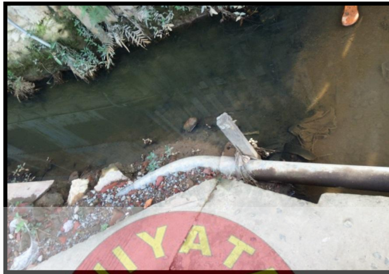
Gambar 1. Kondisi pipa sebelah kanan jalan
