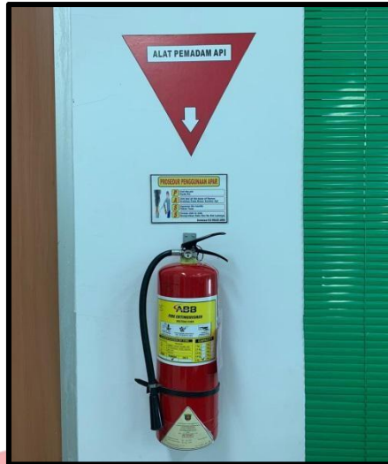
Gambar 3. Alat APAR di Laboratorium Mikrobiologi
