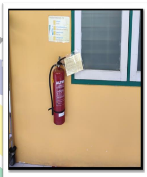
APAR di UPTD Laboratorium Kesehatan Provinsi Kalimantan Timur.
