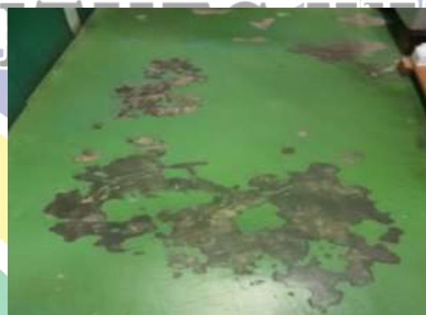
Gambar 16. Kondisi Lantai Laboratorium Imunologi
