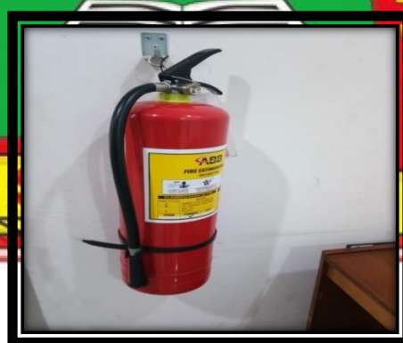
Gambar 18. APAR yang terdapat didalam laboratorium
