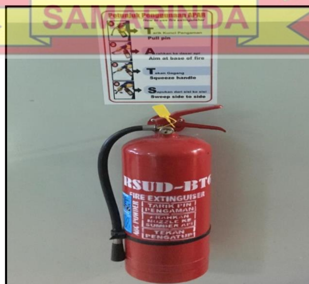
Gambar 12 Alat pemadam kebakaran
