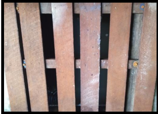
Gambar 22. Bak Penampungan Air Limbah
