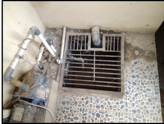
Gambar 1. Bak penampungan air limbah
